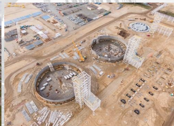
Zbiorniki na propan oraz etylen
